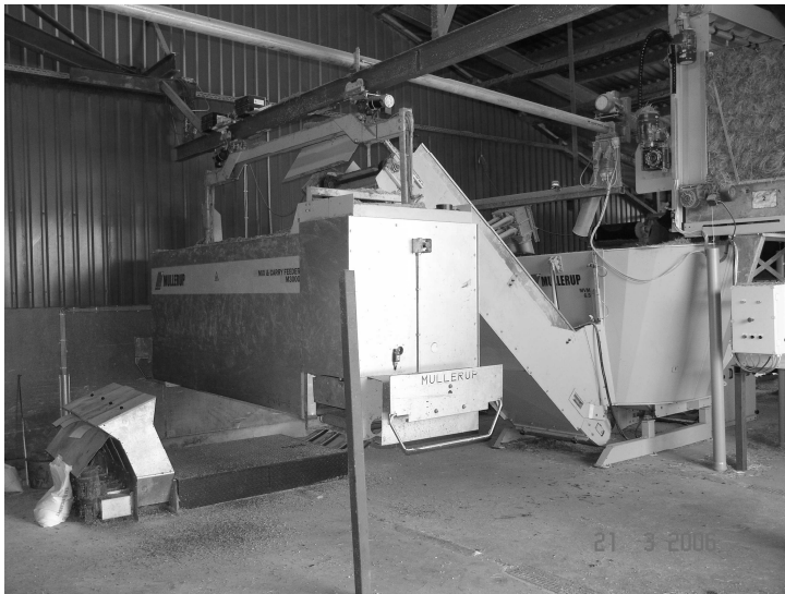
15. att. Lopbarības maisījuma sagatavošanas telpas iespējamais risinājums, izmantojot lopbarības izdales robotu
