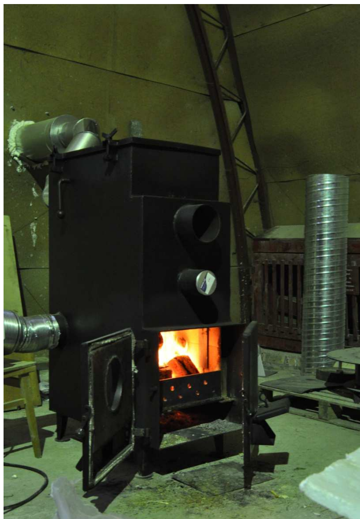
174. att. Kurtuves funkcionālā pārbaude
