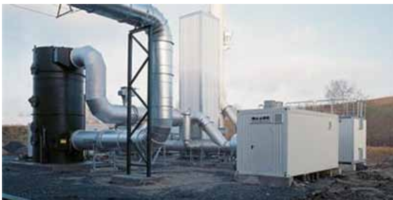
2.8.attēls. «HAASE VocsiBox» reģeneratīvās termālās oksidācijas (RTO) iekārtas piemērs.
