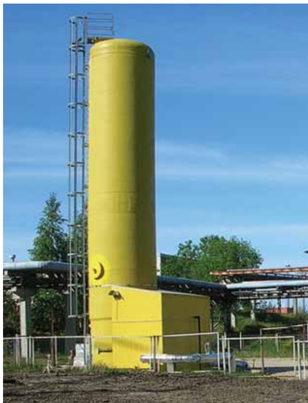
3.1.attēls. Sērūdeņraža filtrēšanas iekārta.
